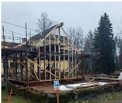
Kasarminkankaan esiintymislavan rakennustyöt on aloitettu. Lava ja siihen liitetty esityskäikkiä mahdollistavat monipuolisen tapahtumien järjestämisen Kasarminkankaalla. Parhailaan etsitään kahvilapalvelun tuottajaa alueelle.
